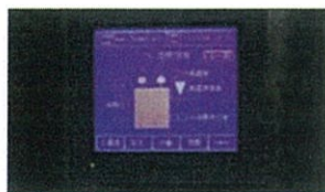
PLC+タッチパネル
